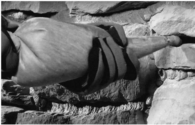
Rys. 20 Spoinowanie okładziny z użyciem rękawa. Fig. 20 Grouting the cladding with a sleeve.
